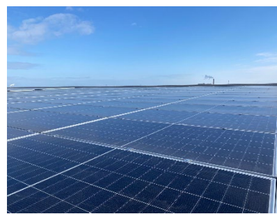
『太陽光パネル』
