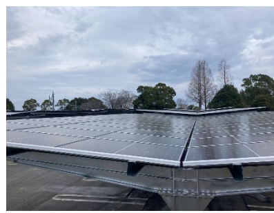
太陽光パネル
